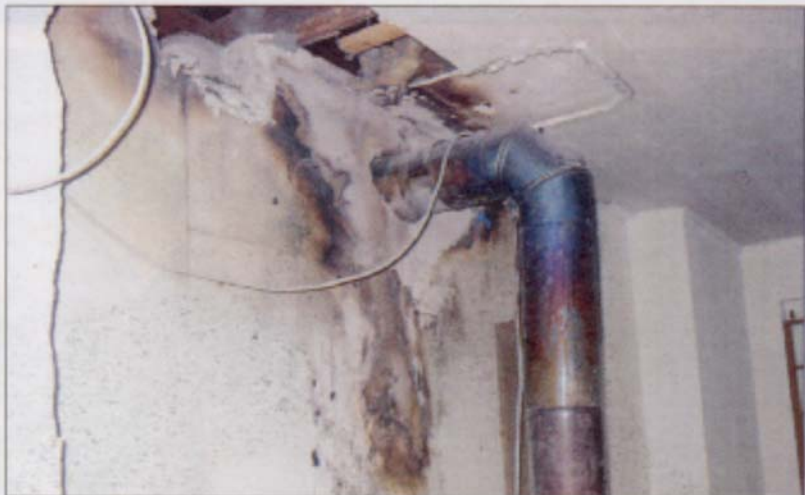
Kleine Ursache, große Wirkung: Ein Schmelbrand sorgte für den ersten Feuerwehreinsatz in Eltville im neuen Jahr.
